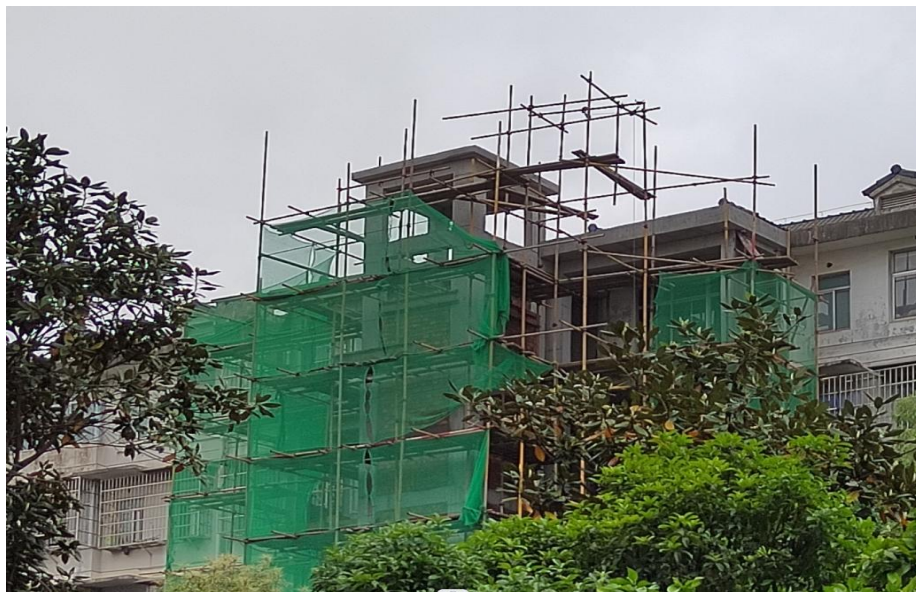
图 1 事故现场照片
