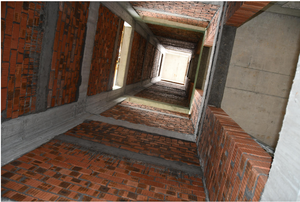
图 4 事故现场井道内照片
