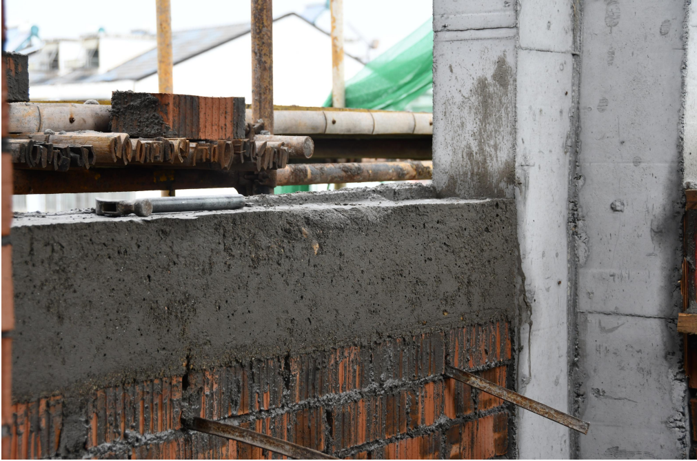
图 3 坠落位置现场照片
