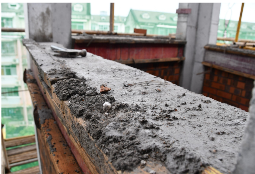
图 2 坠落位置现场照片
